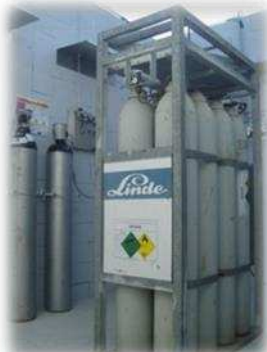
d) Zone de stockage O 2 et N 2
