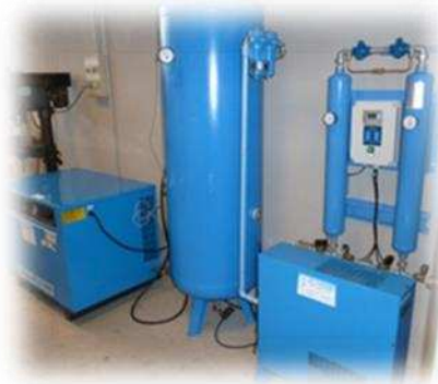
e) Compresseur d'air et circuits de séchage.
