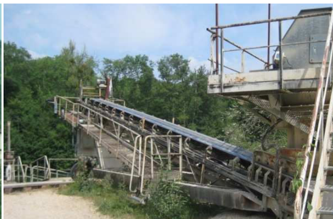
Goulotte d'évacuation des granulats à destination de la voie d'eau
