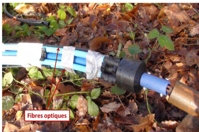
Figure 111 : Vue du pied de la sonde géothermique coaxiale (5 tubes) équipée de sa fibre optique de mesure de température
