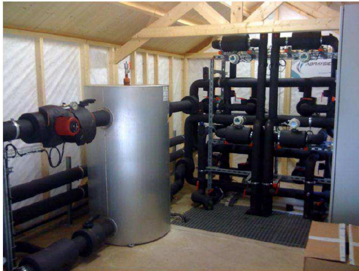
Figure 108 : Machinerie thermodynamique de régulation en chaud et en froid des échangeurs géothermiques
