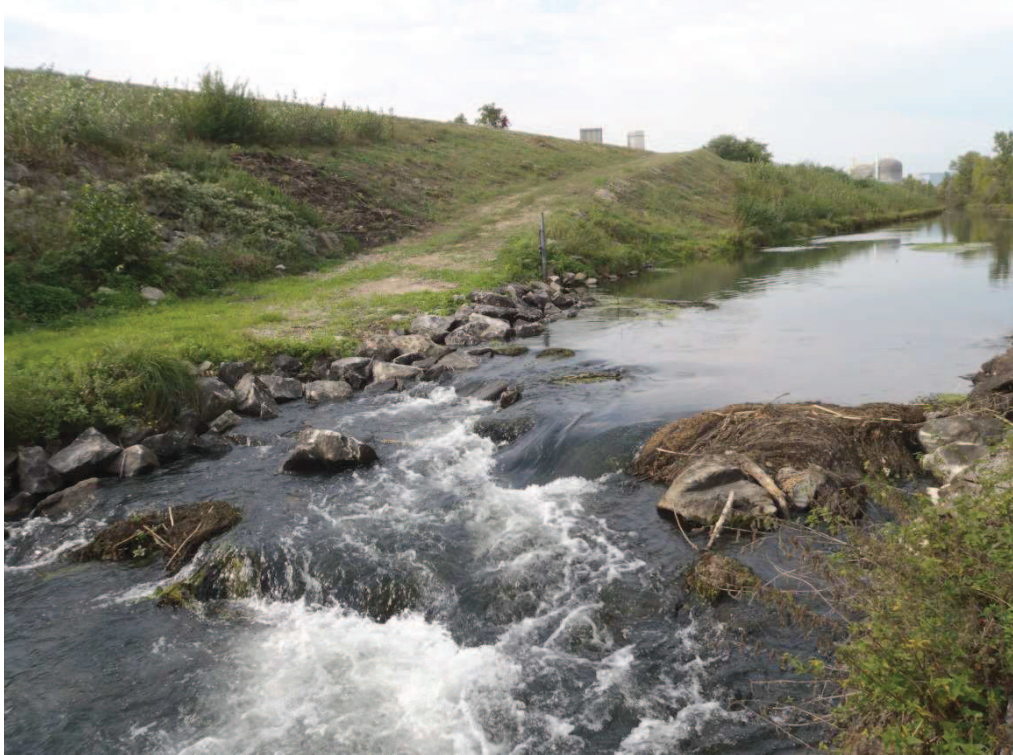
Figure 124: Chute d'eau sur le contre-canal situé en rive gauche du canal de dérivation.
