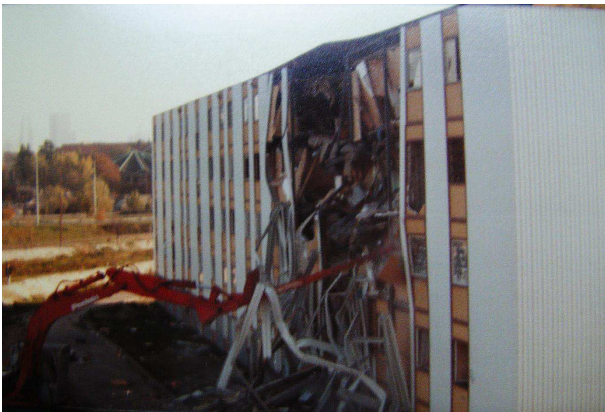
Figure 10-6: Destruction de la cité de transit Pont de Bezons en février 1986
