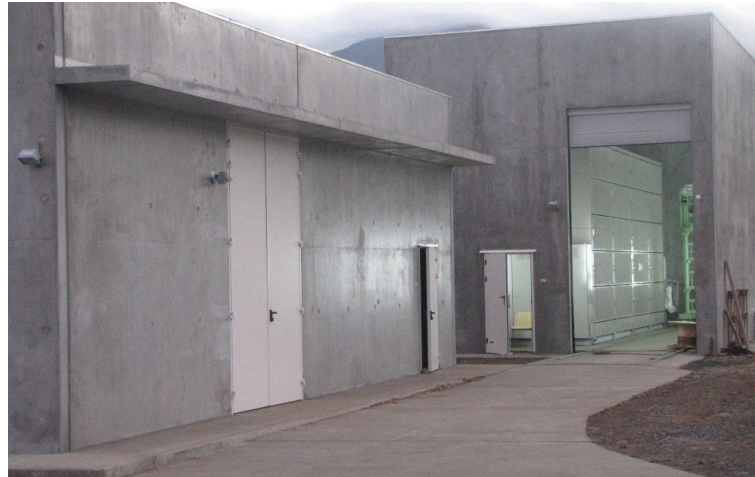
FIGURE 2.7 – Batterie NaS de 7.2 MWh/1 MW installée en 2009 par EDF sur l’île de La Réunion. (on aperçoit les 20 modules de 350 kWh à l’intérieur du bâtiment)
