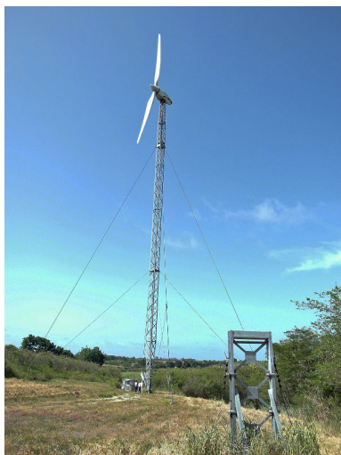
FIGURE A.1 – Une des 5 turbines Vergnet GEV-MP de la ferme Grand Maison en Guadeloupe.
