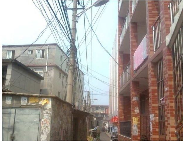
Fils électroniques chaotiques. les infrastructures fonctionnent en surrégime.
