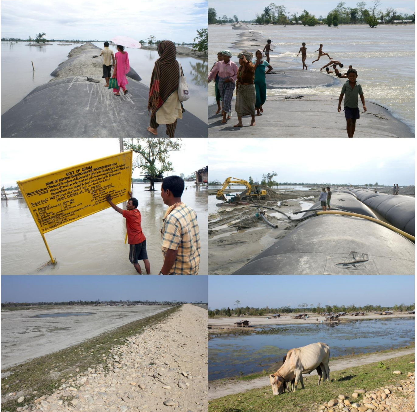
Planche photo 34 : Construction de la digue (Dhakuakhana). 1 et 2 - En 2009, la construction de digue a été interrompue par la crue du 1 er juillet au 30 août ; 3 - Le panneau de présentation des caractéristiques de l'aménagement a été emporté par les flots ; 4- Les travaux ont repris après la décrue ; 5 et 6 - En janvier 2011, la digue construite et le village d'Ekoria Matmora pu se réinstaller en arrière.
