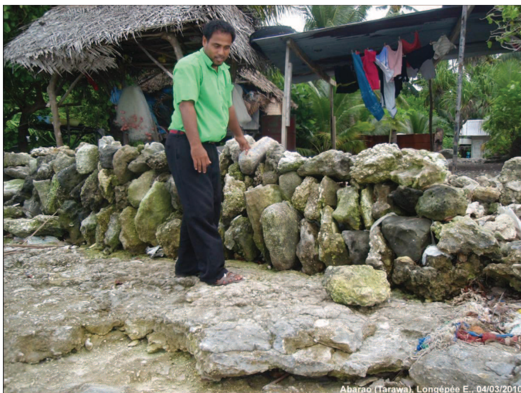
Photographie 41. Homme à Abarao (Tarawa Sud) montrant qu'il brise le conglomérat au devant de sa propriété pour construire son mur de protection.
