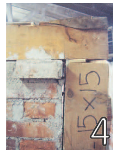
(c) Sortie d'une brique et décrochement du haut du poteau dû au confinement important
