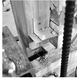
(a) Dû au mouvement de corps rigide : rupture de la connexion basse du poteau d'extrémité
