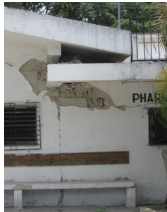
(b) Dalles de toitures à des hauteurs différentes : endommagement des poteaux, Haus et al. [81]
