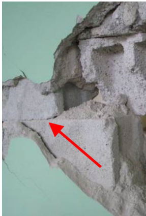
(a) Le mortier se désagrège facilement et son épaisseur entre les parpaings est réduite au maximum, Haus et al. [81]
