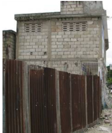
(b) Panneau de maçonnerie vertical au droit du chaînage, Haus et al. [81]
