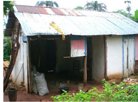
(c) Chute d'un pan de mur entier due à un problème de conception
