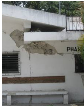
(b) Dalles de toitures à des hauteurs différentes : endommagement des poteaux, Haus et al. [81]
