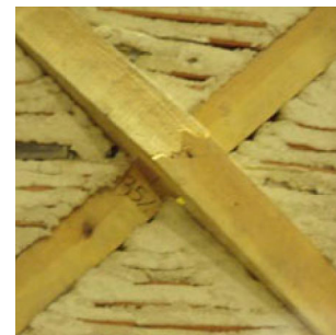
(c) Essai 2 et 3 : après renforcement des angles, rupture hors-plan du contreventement
