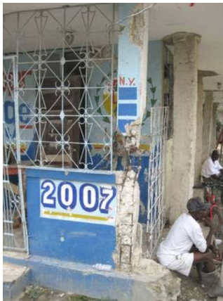
(a) Cisaillement d'un poteau par effet de poteau court induit par un remplissage partiel, Haus et al. [81]
