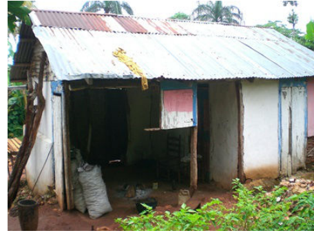
(c) Chute d'un pan de mur entier due à un problème de conception
