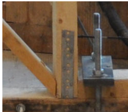
(d) Connexion de type-1 du mur élémentaire sans remplissage à la fin du test cyclique
