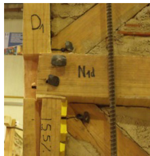
(b) Essai 1 : rupture des connexions intermédiaires mi-bois des poteaux
