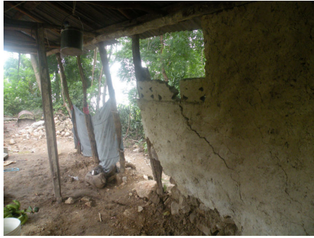
(b) Chute des panneaux de remplissage due à un manque de maintenance et à un problème de conception, [8]
