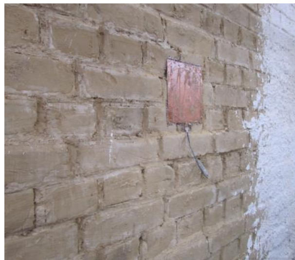
Emplacement du fluxmètre
