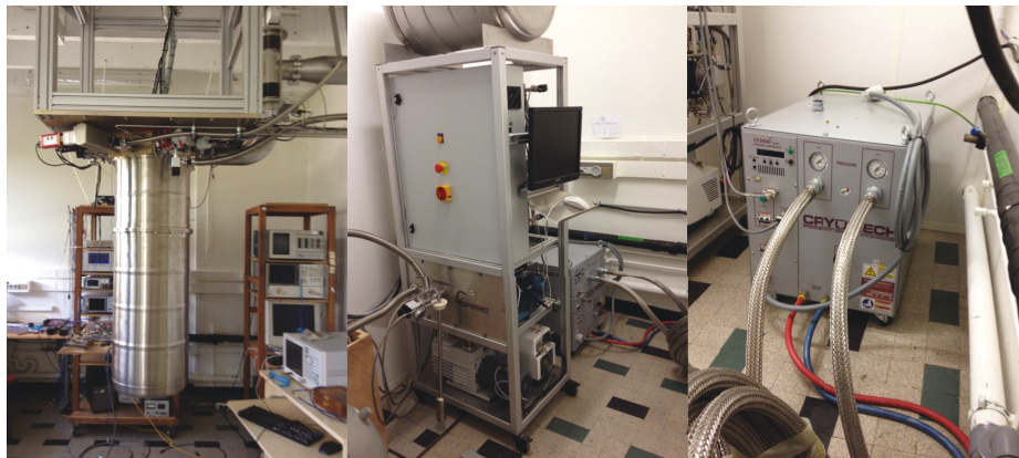
FIGURE 3.11 – Réfrigérateur "Cryofree" de nouvelle génération et son équipement. En construction en ce moment au laboratoire. A droite Un compresseur à hélium de puissance 7.9 kW.
