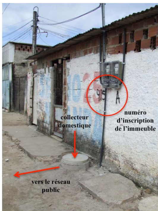
Photo 4-1 : Le réseau domestique d'assainissement dans Campo Grande
