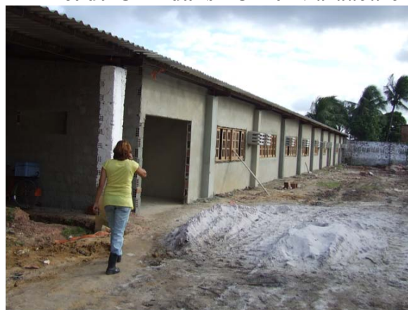
Photo 2-28 : Installations définitives de l'EL et du CDL dans l'UE-07 Varadouro
