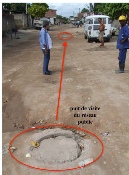
Photo 4-2 : Le réseau public d'assainissement dans Campo Grande
