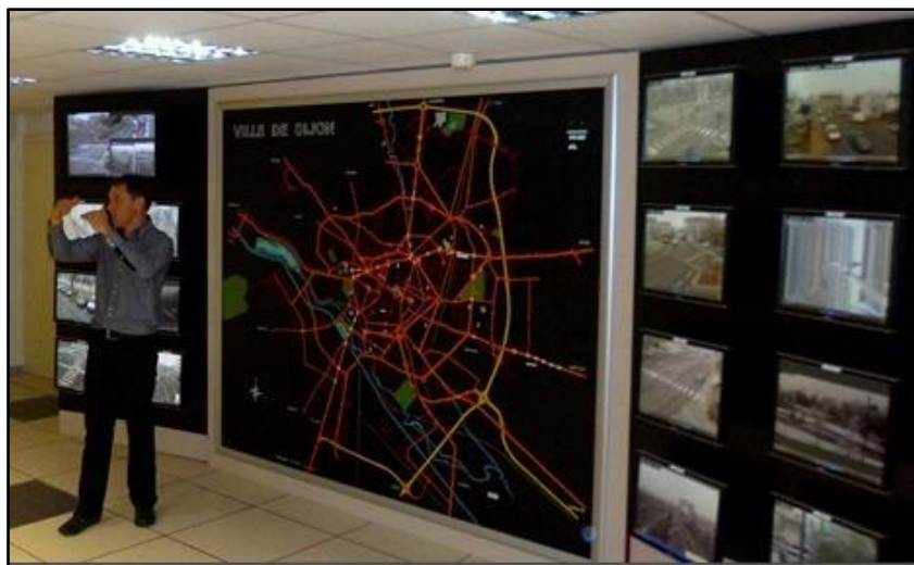
Figure 1.23 : Illustration du PC de la circulation routière de la ville de Dijon (au centre, l'écran de contrôle à diodes des carrefours à feux ; de chaque côté de l'écran de contrôle des écrans numériques permettent de visualiser l'état du trafic routier en direct par l'intermédiaire de caméras)
