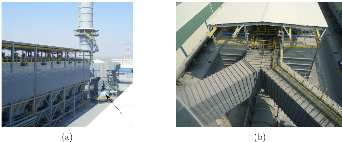
FIGURE 2 – Illustrations d'un centre de traitement de gaz. (a) : Filtres (à gauche) et ventilateur de tirage (flèche); (b) : Gainés situées en sortie de Filtre
