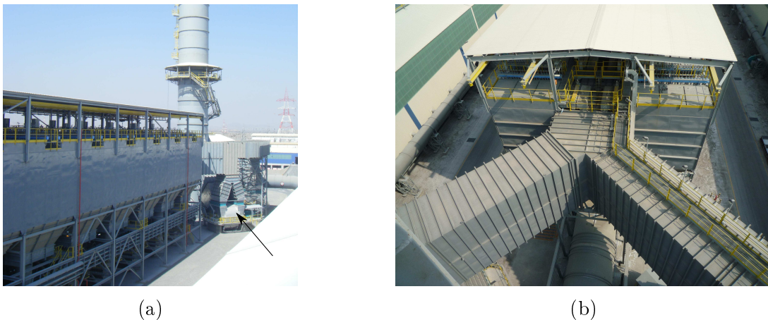
FIGURE 2 – Illustrations d'un centre de traitement de gaz. (a) : Filtres (à gauche) et ventilateur de tirage (flèche); (b) : Gainés situées en sortie de Filtre
