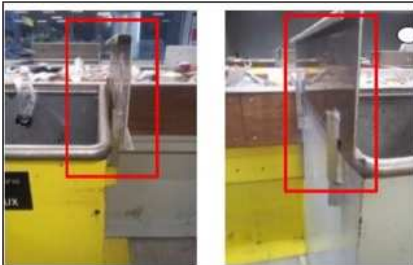
Figure 45 : rehausses créées au-dessus des exutoires fixes afin de limiter le nombre de déchets au sol (CDT4)
