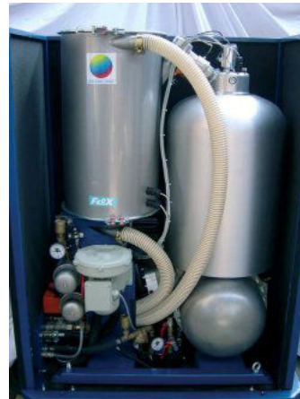
(b) Unité de cogénération CHP "Sunmachine" (biomasse, pellets)
