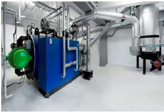
(a) Unité de cogénération CHP "StirlingDK" (biomasse, gazéification)
