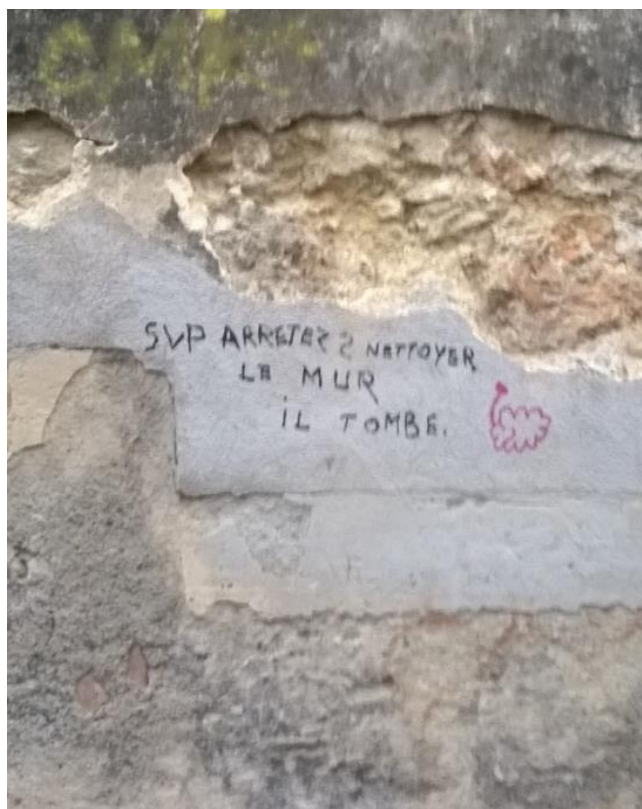
Image n°42 : « SVP arrêtez de nettoyer le mur, il tombe ! », Montpellier
