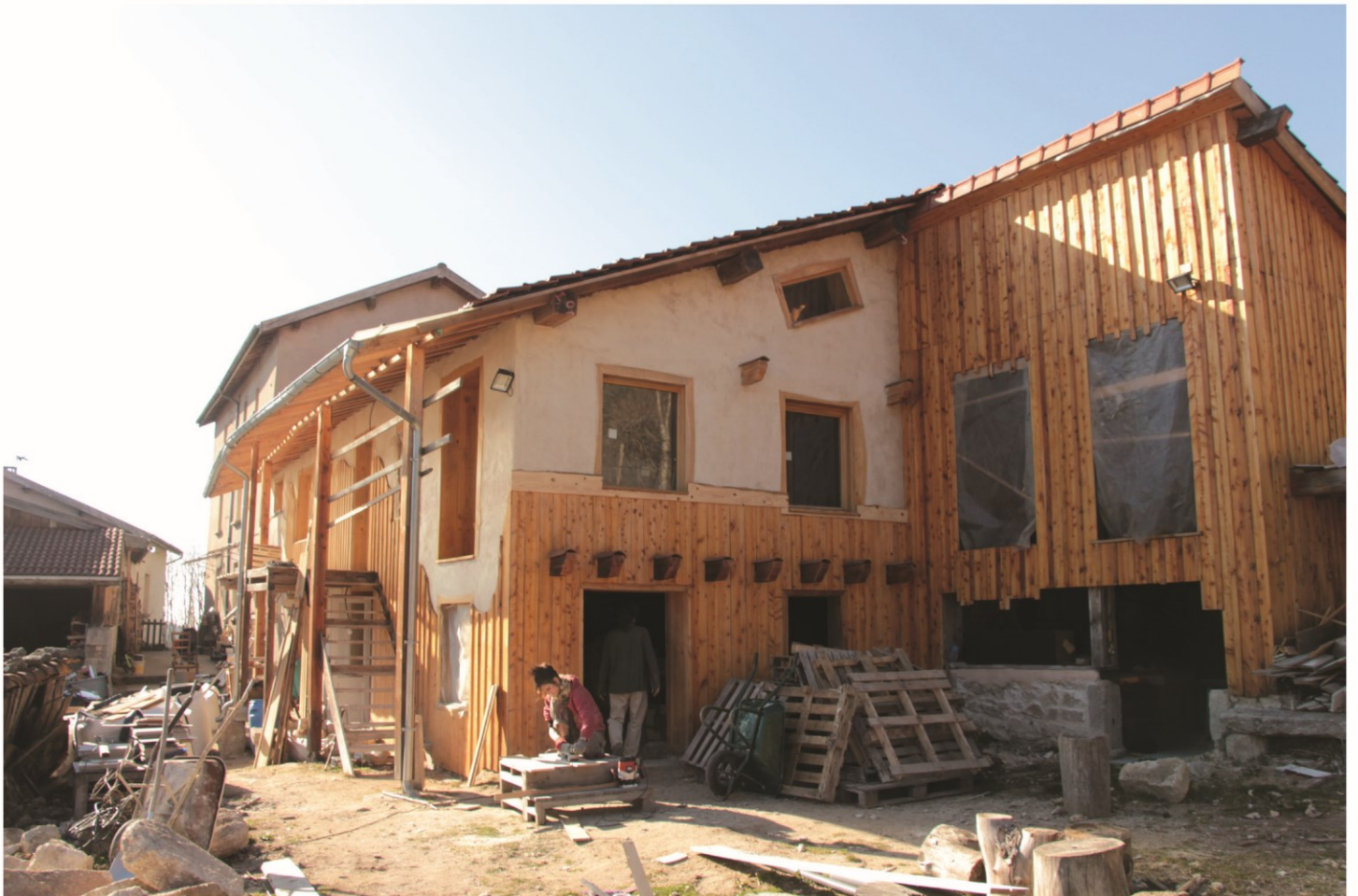
Photographie 27. Ferme du pot commun : chantier de l'extension bâtie, finalisation en cours des parements extérieurs
