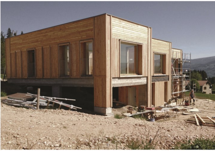
Photographie 7. Puy-Bayou : construction des logements en ossature bois et soubassement en béton et en pierres (© Boris Bouchet architectes)
