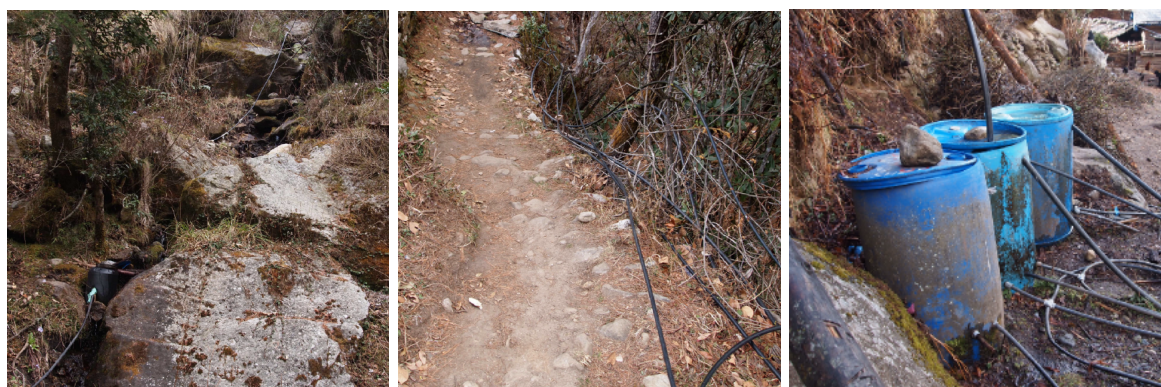
(a) Prises d'eau dans la rivière (b) Tuyaux d'adduction le long du chemin de trek (c) Citernes d'adduction collective
