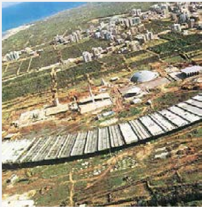
Vue du chantier de la foire internationale de Tripoli en 1973 - Ordre des architectes et ingénieurs de Beyrouth.
