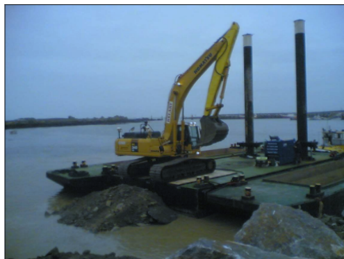
Figure B-2 : photographie d'un dragage mécanique par une pelle hydraulique mobile équipée pour des travaux maritimes (Marrec A., 2012)
