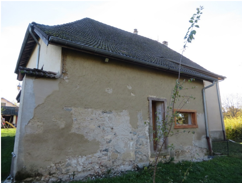
Figure 40. Façade arrière de la maison de Gilles qui essaye de remplacer progressivement l'ancien enduit au ciment par un enduit qu'il a composé avec la terre issue de la démolition de mur intérieurs de la maison. Octobre 2015.
