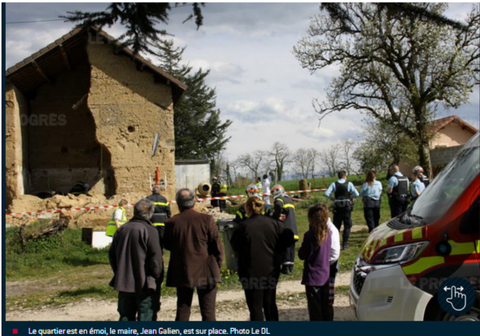
Figure 39. Chapeau d'un article paru dans Le Progrès Nord-Isère , le 13 avril 2016. © Le Progrès , V.W. L'article précise que « intervenant sur une ancienne grange en pisé afin d'effectuer une ouverture, tout un pan d'un mur s'est effondré, piégeant l'artisan qui s'est retrouvé les jambes et le bassin ensevelis sous plusieurs m 3 de terre ».
