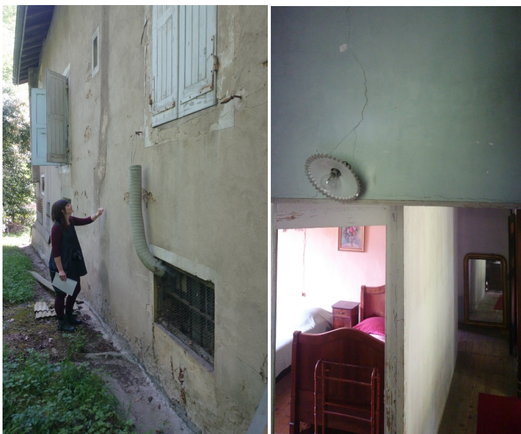
Figure 55 (à gauche) : Diagnostic avec Julie Avons-Bariot. Avril 2018. L'architecte sonde la qualité de l'enduit en toquant dessus avec le poing.
