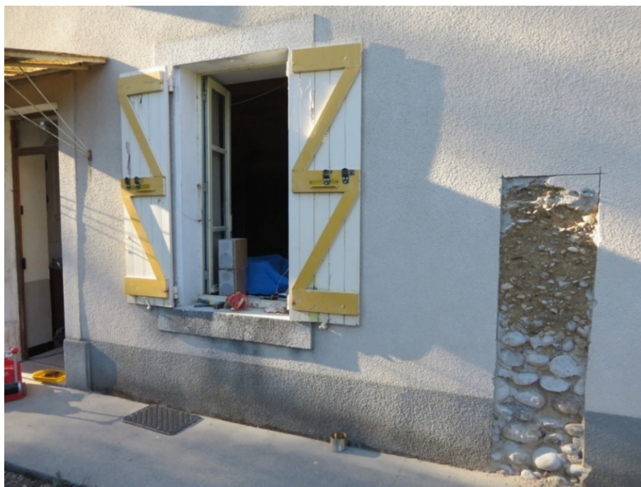
Figure 41 : Sondages réalisés par Benoît dans l'enduit extérieur pour voir dans quel état est le pisé. Avril 2015.
