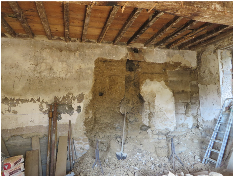
Figure 64. Chantier de Ruy Montceau. Septembre 2015. Ouverture en cours de perçage dans un mur en pisé. La terre issue du mur est autant que possible récupérée pour être réutilisée.
