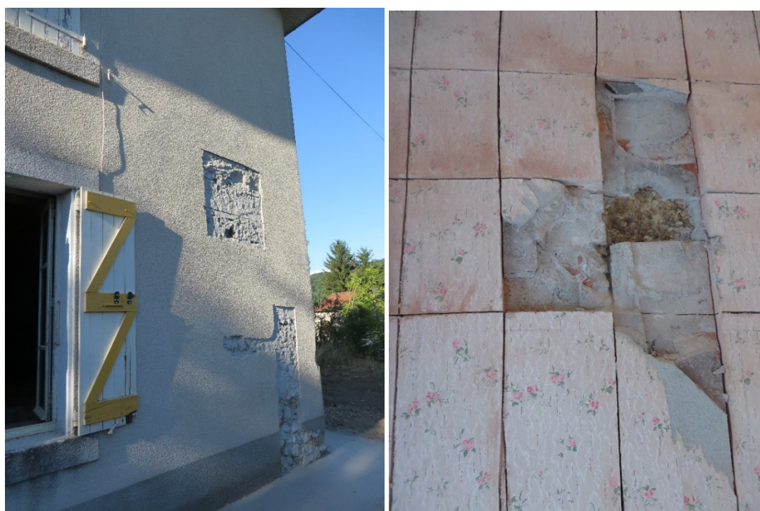
Figure 42 (à droite) : Sondages réalisés par Benoît. Avril 2015. Sous l'enduit apparaissent du béton de ciment et du mâchefer, qui suggèrent des hypothèses sur la date de construction de la maison et sur les transformations qu'elle a déjà pu subir.
