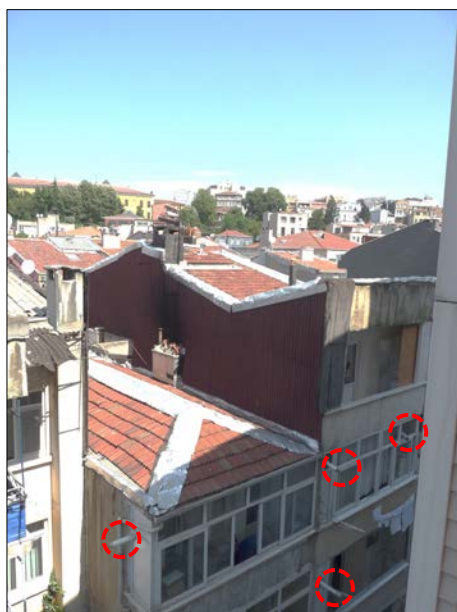
Immeubles dégradés et mal-isolés du centre-historique de Beyoğlu. Crédit E.A., 06/11/2013.
