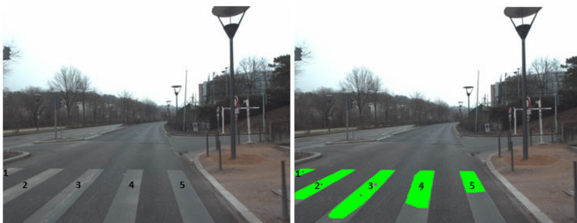
FIGURE 2.36 - Exemple 1 d'un passage piéton quasiment effacé sur la chaussée - lat=45.7833^\circ , lon=4.8487^\circ , note=\frac{3}{10} .
