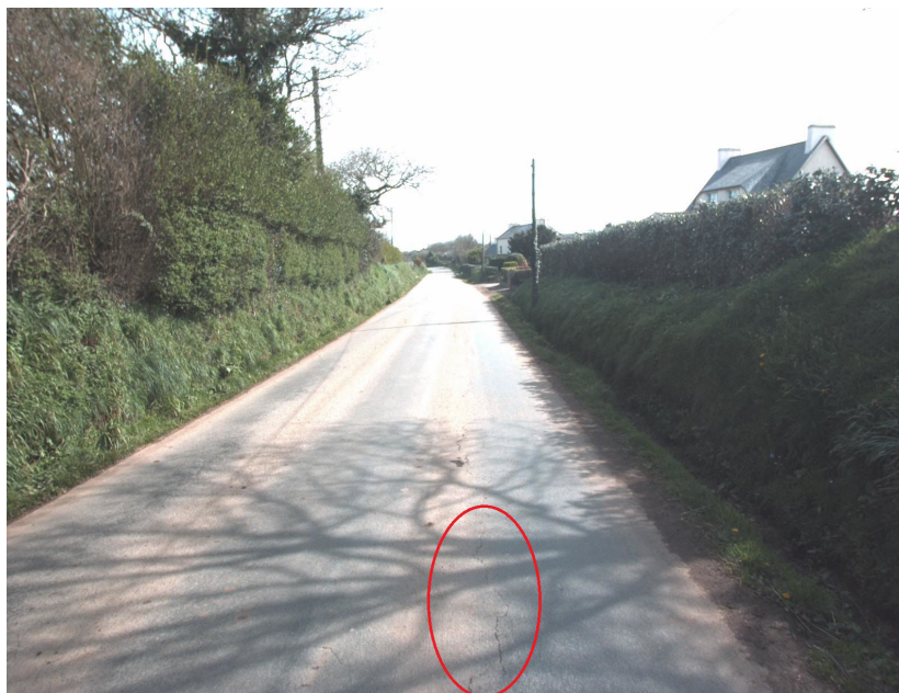
FIGURE 5.6 – Illustration de l’effet perturbateur d’une ombre portée (arbre) pour la détection d’une fissure longitudinale (partie entourée en rouge) dans une image VIAPIX ® .
