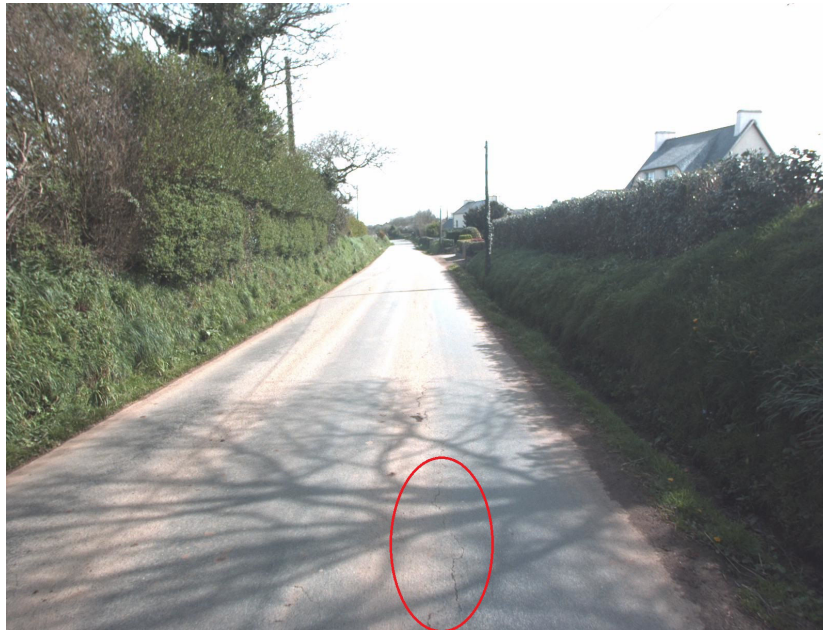
FIGURE 5.6 – Illustration de l’effet perturbateur d’une ombre portée (arbre) pour la détection d’une fissure longitudinale (partie entourée en rouge) dans une image VIAPIX ® .
