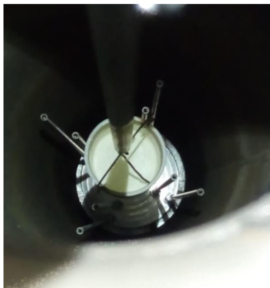
Figure 210 : Dispositif de mesure de température du gaz (photo prise depuis le sas)
