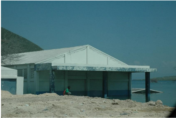
Photo 5 : Installation douanières ensevelies par le Lac Azuéli à la frontière Malpasse-Jimani le 19 juillet 2011
