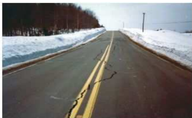
(c) Fissure longitudinale au niveau de l'axe central de la chaussée
