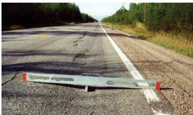
(a) Des ornières se forment et la surface s'affaisse dans les bandes de roulement avec des fissures longitudinales
