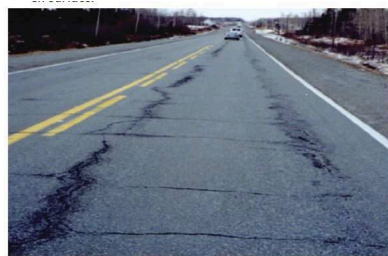
(b) La fissuration s'accroît et d'autres fissures apparaissent en surface
