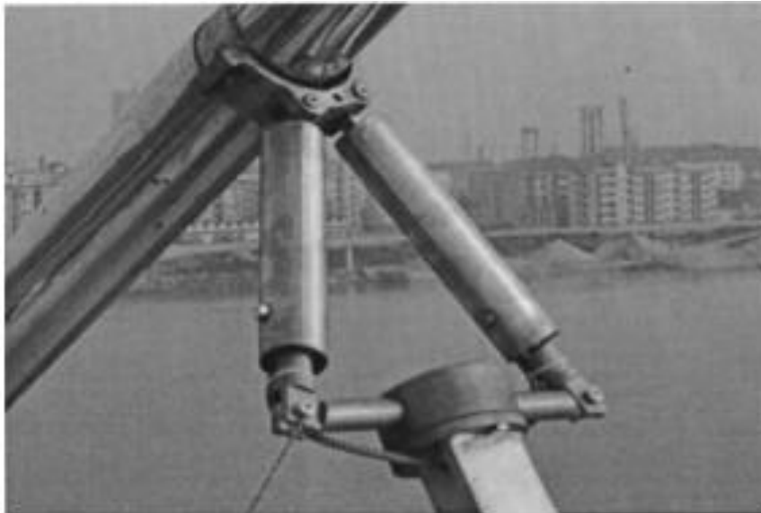
Figure 17 : Installation d'amortisseur avec du fluide MR sur le pont du lac de Dongting en Chine, adapté de [117].
