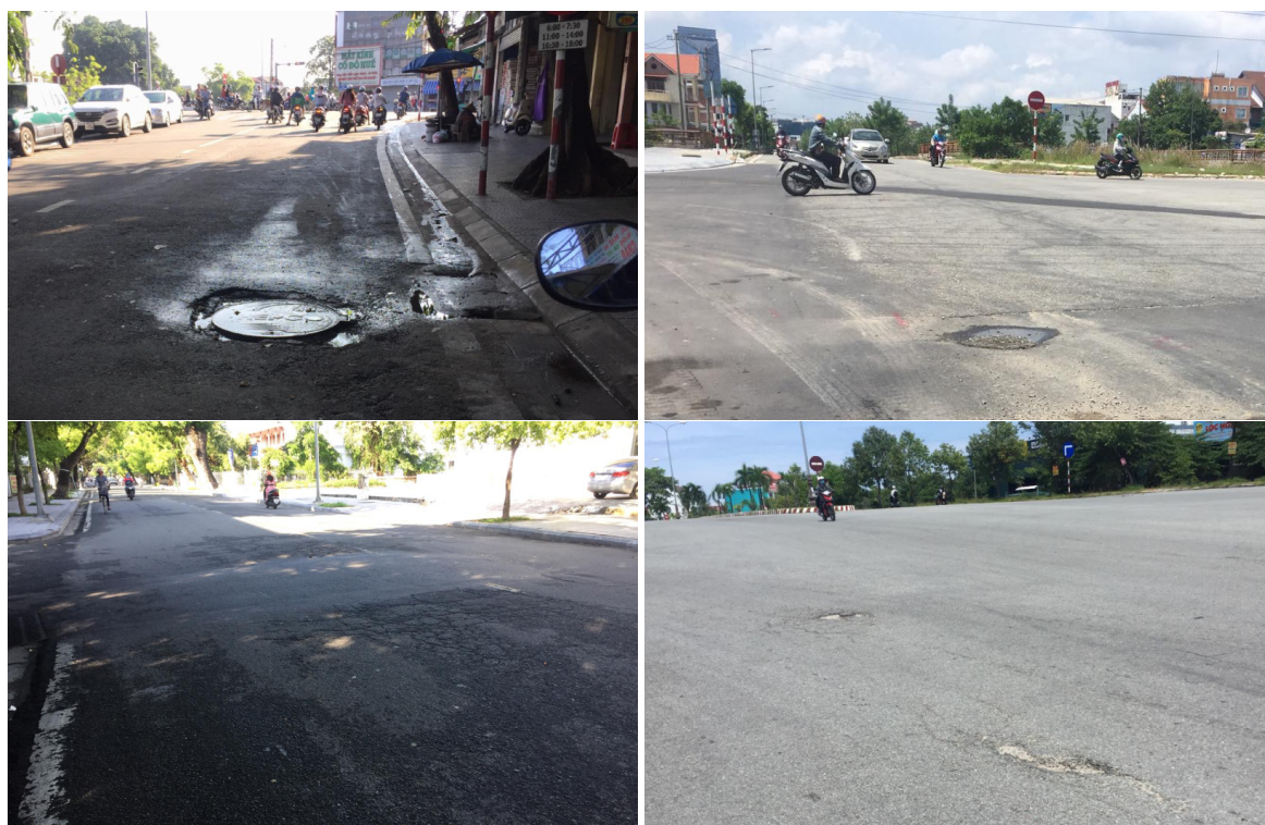
FIGURE 4.3 – Quelques images d’anomalies routières à Hué.
