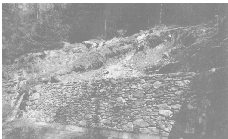
Figure 2.26 : Barrage dont le but est de stabiliser le profil en long du torrent et de stopper le phénomène d'érosion régressif, dans le Vicdessos en Pyrénées Ariégeoise (Bonnet, 1986).
