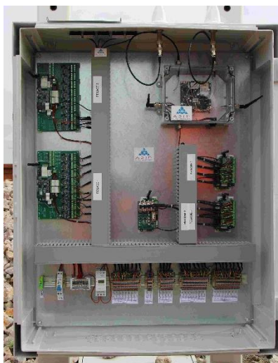
Figure II.12 – Cartes Pégase installées dans un coffret sur une section de la voie BPL
