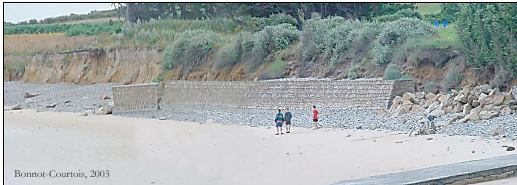
Fig. 116 : Destruction du mur de soutènement à Pors-Hir (29/07/2003).
