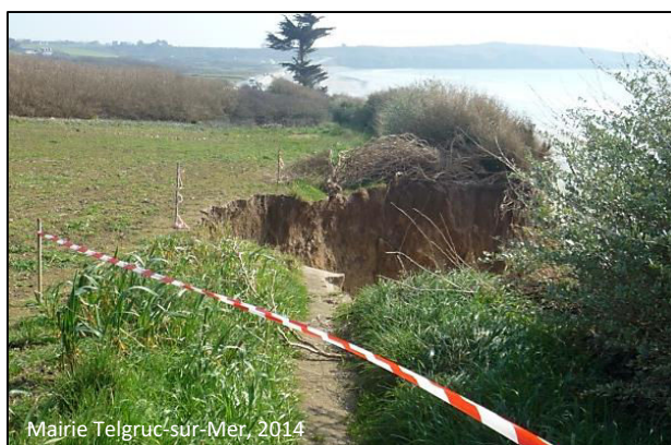
Fig. 131 : Glissement le 2 février 2014 entrainant un recul de 4 m du sommet de falaise et affectant le sentier côtier.
