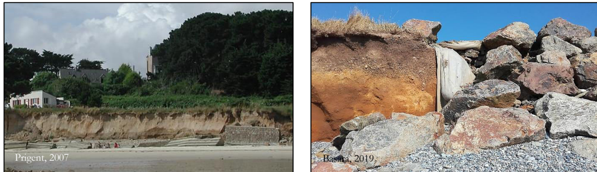
Fig. 242 : Ouvrages de défense contre la mer endommagés suite au recul en arrière des falaises meubles par les eaux de ruissellement et d'infiltration. Photo de gauche : mur de protection effondré à Plougrescant (2007). Photo de droite : glissement des blocs de Penrochement à Plovan et mise à nu du géotextile (2019).
