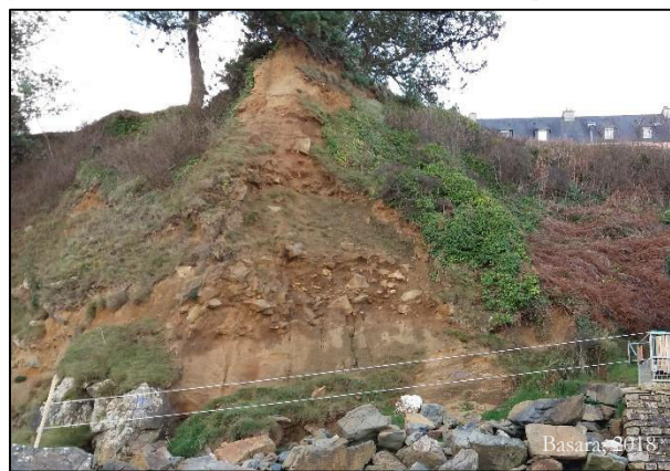
Fig. 183 : Résurgence d'eau et ruissellement visibles dans la partie inférieure de la falaise.
