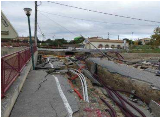
a) Arrachement de chaussée suite au débordement du canal du Midi sous la poussée de l'Orbiel, affluent de l'Aude (Trèbes - Aude)
