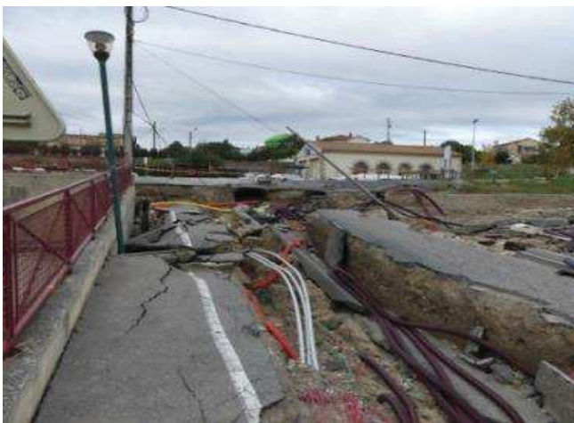
a) Arrachement de chaussée suite au débordement du canal du Midi sous la poussée de l'Orbiel, affluent de l'Aude (Trèbes - Aude)
