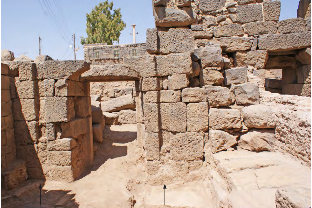
Ph. 133. Les bains. Les cheminées d'évacuation d'air chaud en L. 034, appartenant à l'état original des bains
