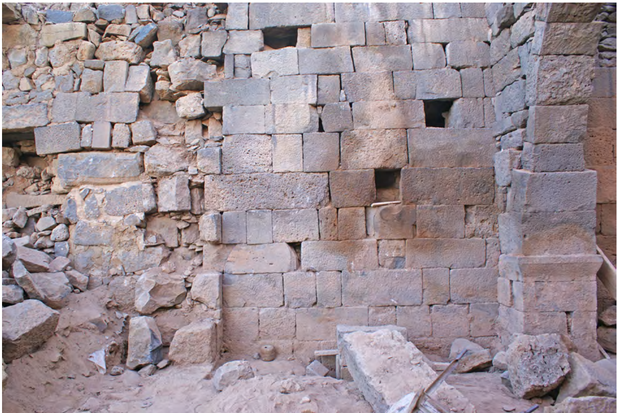
Ph. 70. Le « Palais de Trajan ». Vue intérieure dans la salle L. 019, lacunes dans le mur oriental
