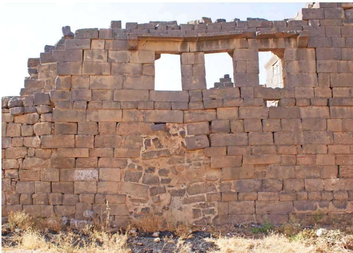
Ph. 59. Le « Palais de Trajan ». Grandes fenêtres de l'étage de la façade sud extérieure
