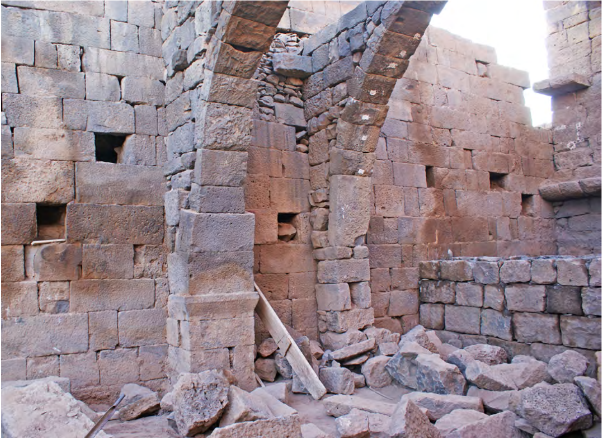
Ph. 34. Bâtiment sud. Vue générale de la salle L. 019, en cours de restauration (2009)
