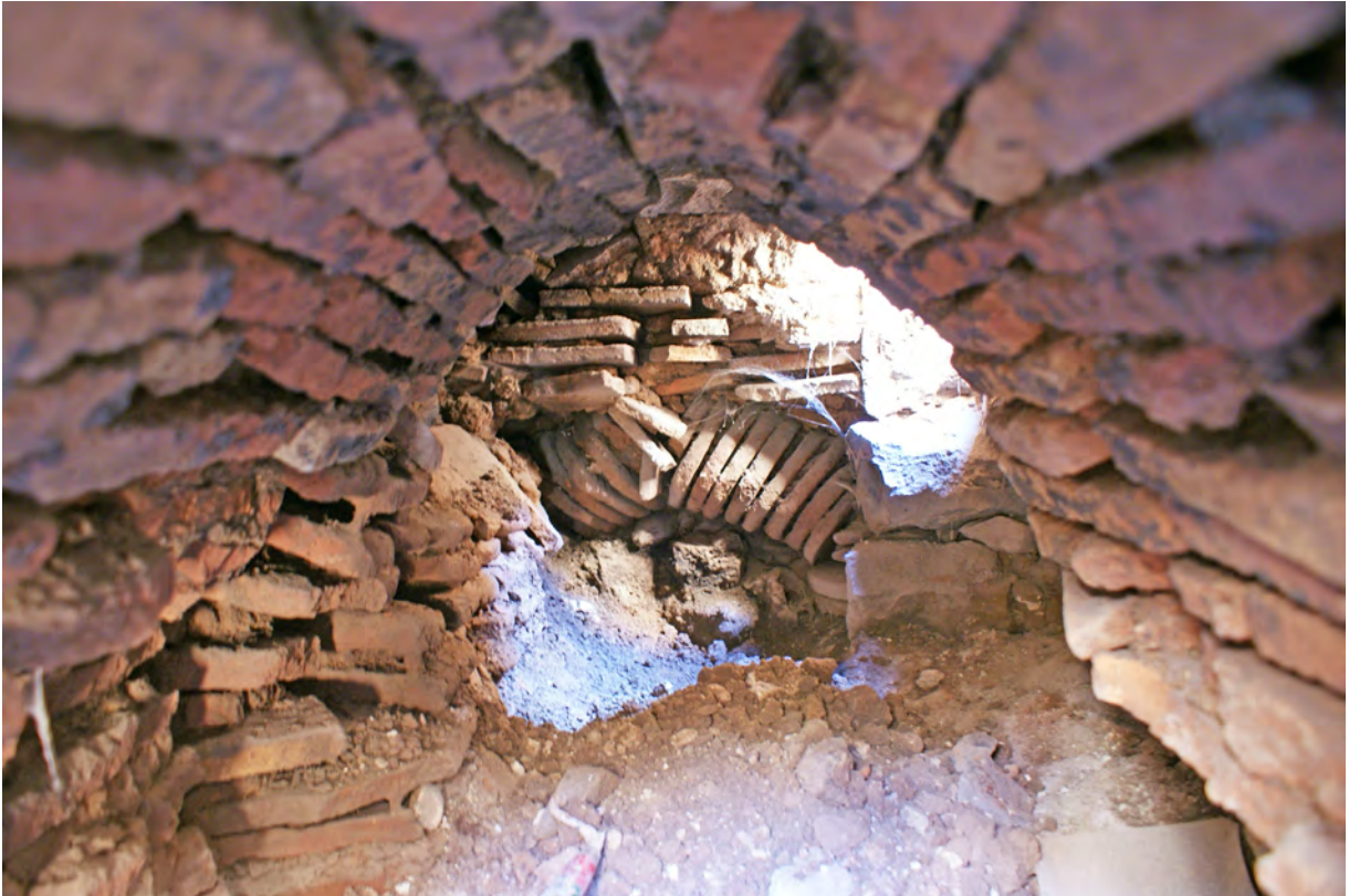
Ph. 113. Les bains. Le sous-sol des hypocaustes dans la salle L. 037, vers le sud
