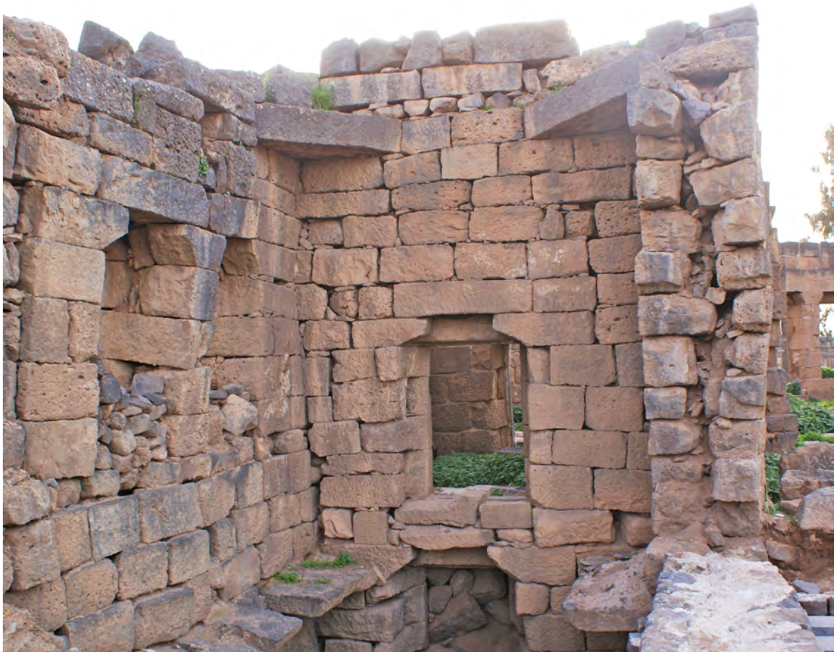
Ph. 50. Bâtiment sud. Angles sud-ouest et nord-ouest de L. 221. Poutres posées en diagonale
