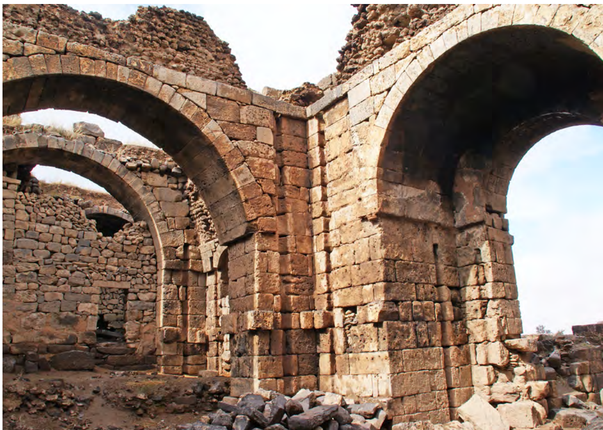
Ph. 204. Bosra, thermes du Sud. Voûtes ruinées
