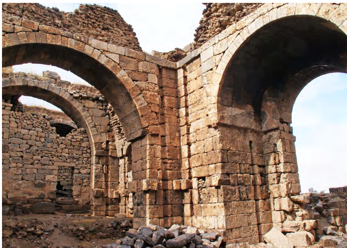
Ph. 204. Bosra, thermes du Sud. Voûtes ruinées
