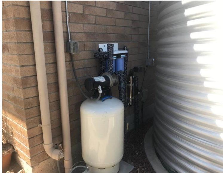
Figure 80 : Système de traitement de l'eau de pluie collectée de D.S. (mars 2019)
