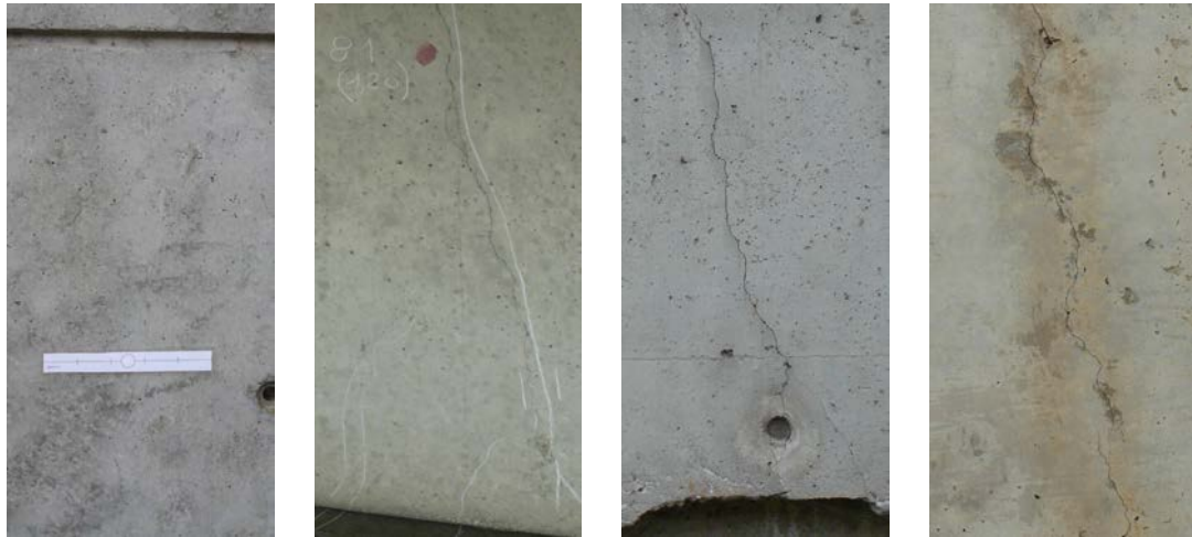
FIGURE 2.1 – Exemples de fissures de différentes tailles sur divers murs en béton.
