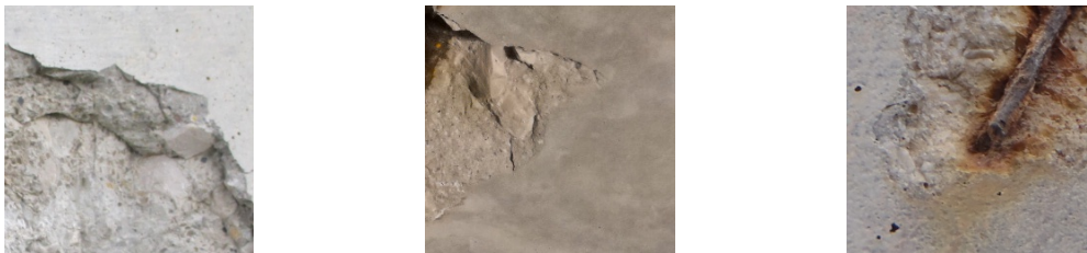
FIGURE 5.10 – Exemples d'images de notre base de données de défauts surfaciques.
