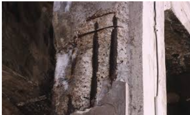
FIGURE 2.8 – Éclatement du béton d'enrobage et corrosion des armatures [IFSTTAR and CEREMA, 2015].
