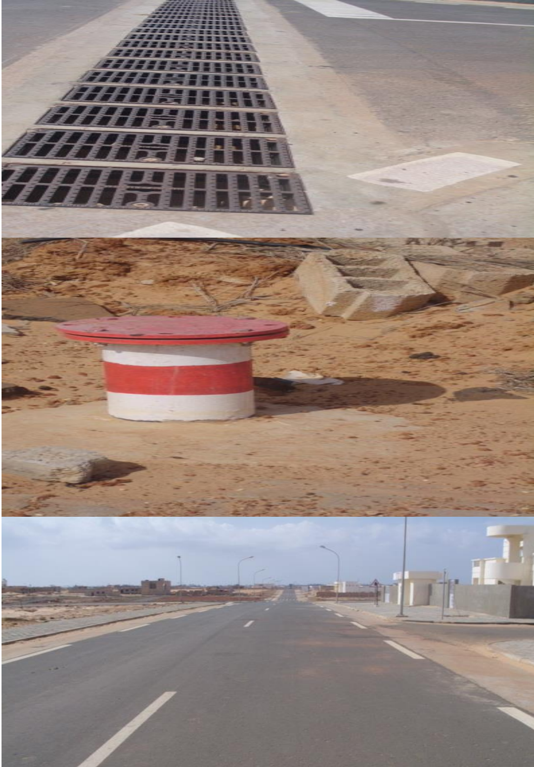
Photo n°16 : Le réseau d'assainissement haut standing (tout à l'égout) cité APIX
