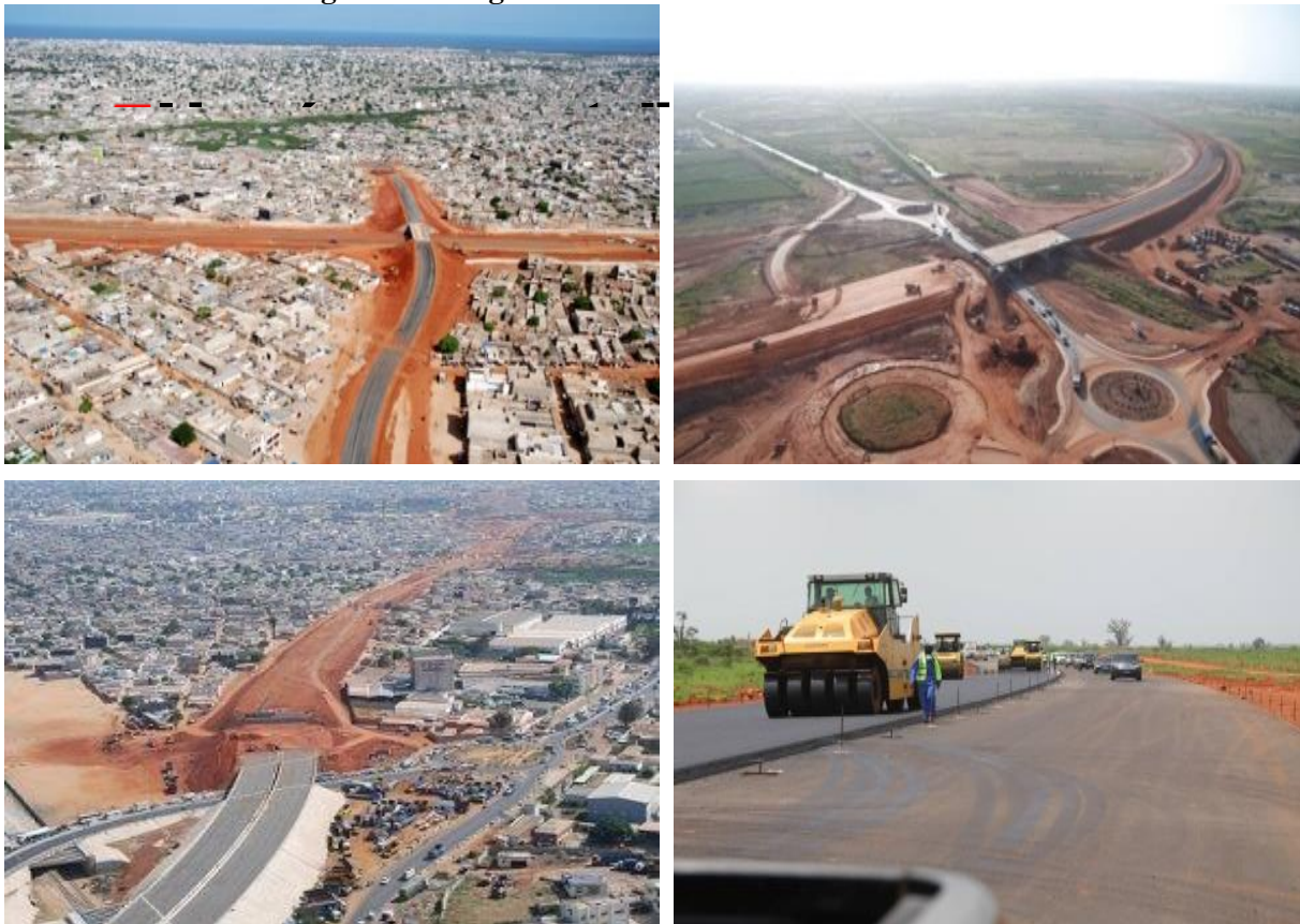
Photo n°2 : Vue des travaux de réalisation de l'autoroute à péage Dakar-Diamniadio et le renforcement du maillage routier régional
