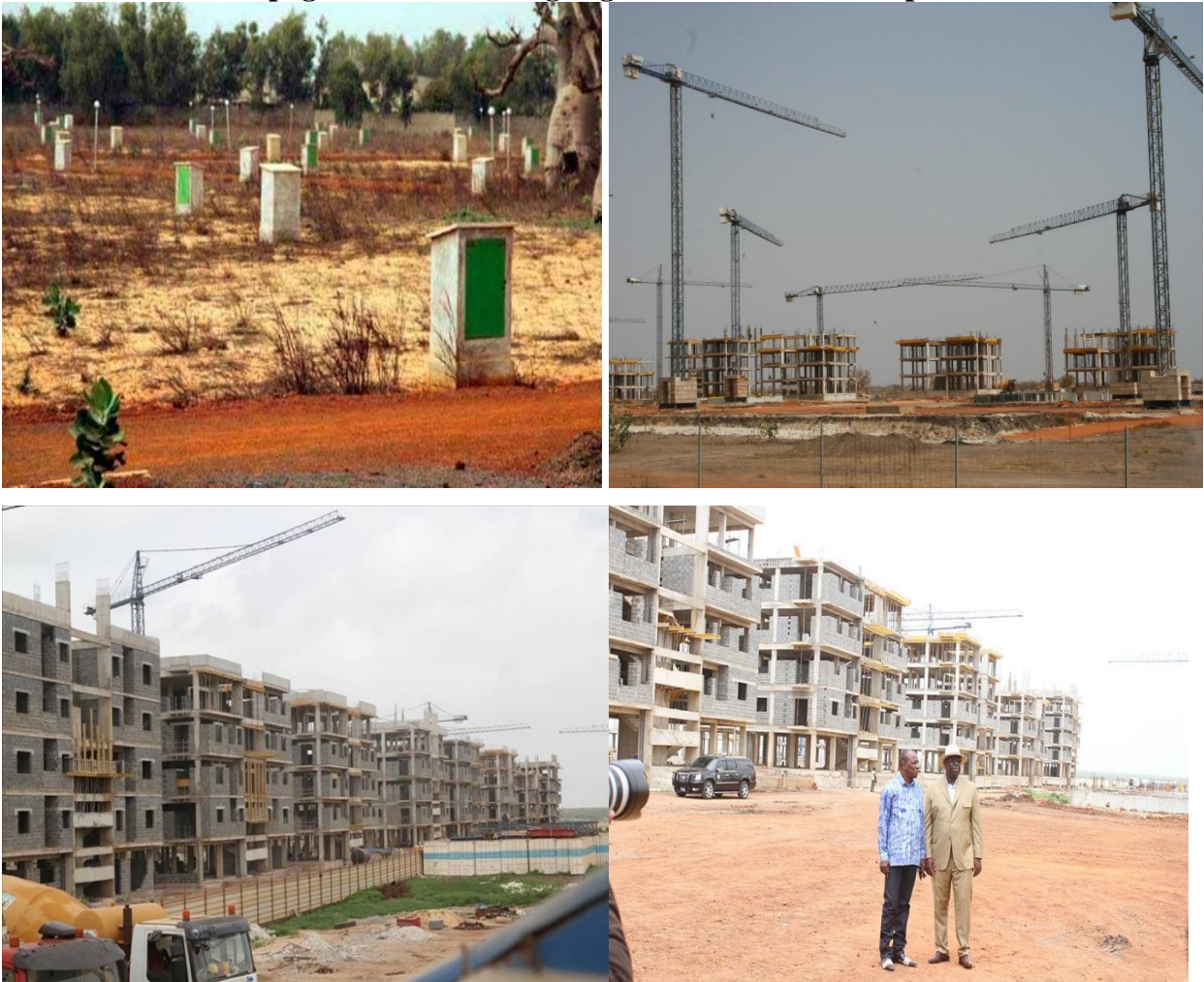
Photo n°22: Visite des chantiers du pôle urbain de Diamniadio par le Président Macky Sall accompagné de son homologue guinéen le Président Alpha Condé
