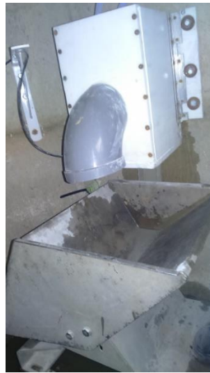
Figure II.27: Débitmètre à augets du parking perméable de Villeneuve-le-Roi
