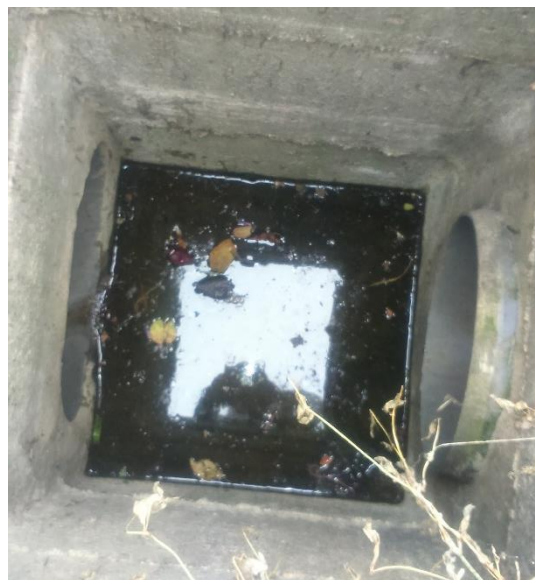
Figure II.19: Avaloir de surface du parking référence
