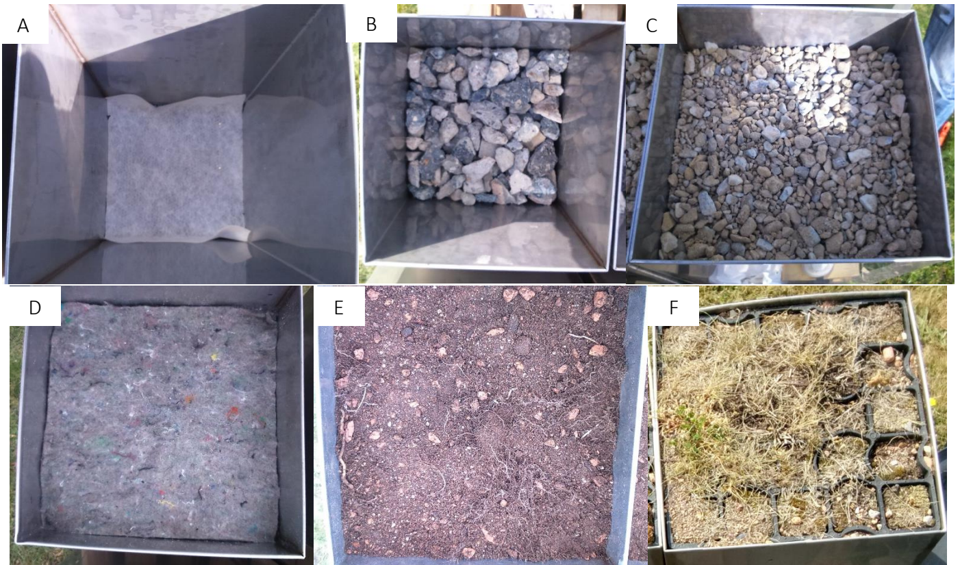
Figure VI.135 : Etapes de la construction des colonnes (A : géotextile ; B : Graves drainantes 40/60 ; C : Graves drainantes 0/31,5 ; D : Natte à rétention d'eau WSM ; E : Substrat Mousses® provenant de Broué ; F : Dalle Mousses provenant de Broué)
