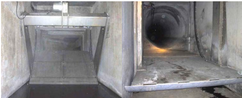
déversoir régulé par une vanne secteur
