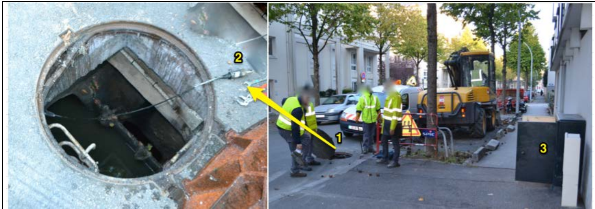
Exemple de site de mesure installé sur un collecteur unitaire non visitable 5 : (1) accès au capteur ; (2) capteur de hauteur ; (3) armoire électrique de commande.
