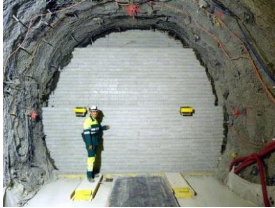
Mur de briques de bentonite remplissant une galerie du laboratoire souterrain (juillet 2012)
