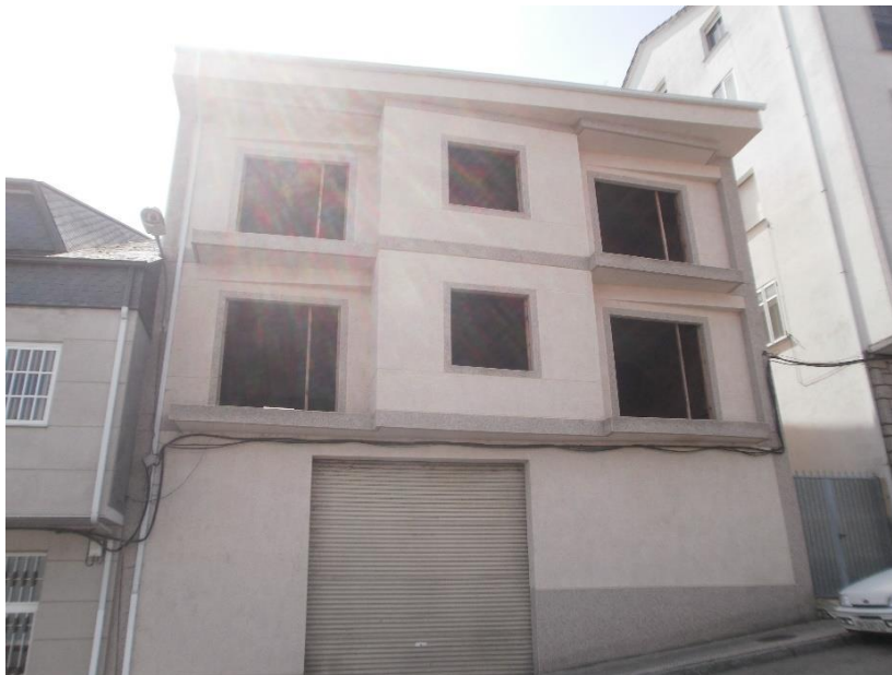
Figure 87 Immeuble où seul le rez-de-chaussée a été achevé, et le reste de la construction abandonnée, Maceda, avril 2016 (Photographie : Brouard-Sala Q.)
