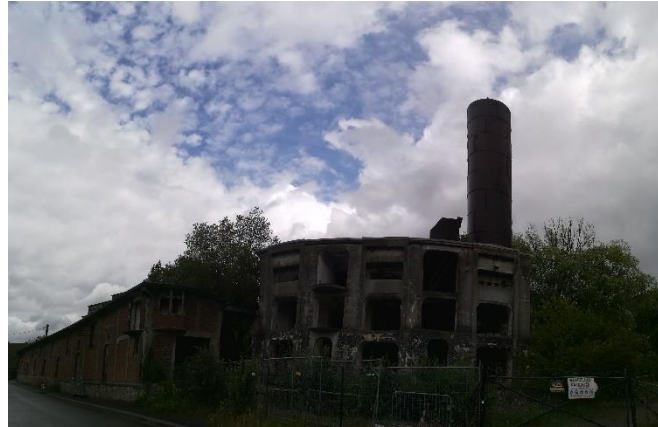
Figure 9.4 : Une ancienne cimenterie à l'abandon, propriété de ceux qui l'ont achetée mais ne l'utilisent pas ou de ceux qui la pratiquent sans la posséder ? Photo : Robin Lesné, 2019.
