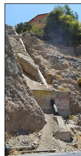
Photographie 48. Tuyaux transportant l'eau depuis la rivière Derecho jusqu'au réservoir
