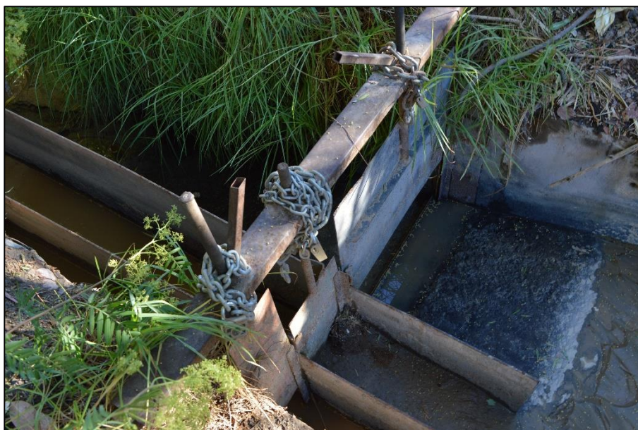
Photographie 52. Vanne du canal de la Communauté d'Eau Potagers de Vicuña et de. Source : CNA, 2017.
