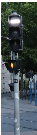
Figure 77 : Exemple de feux R17 avec SAC
