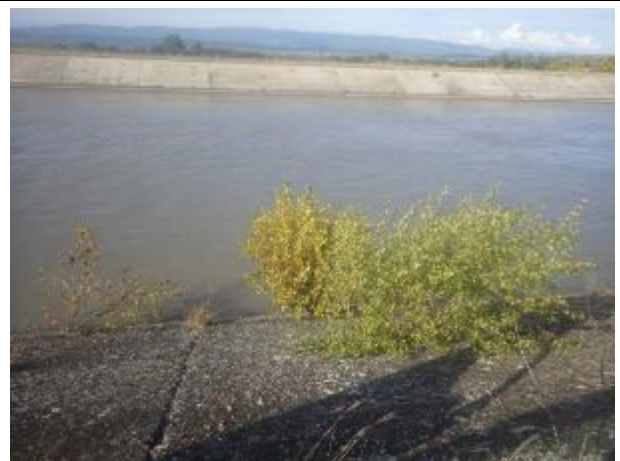
Photo I. 2 : Canal dont le bajoyer est constitué d'un revêtement rigide bétonné, les plaques de bétons sont séparées par des joints et comportent des barbicanes (Photo : Macia J., 2015).
