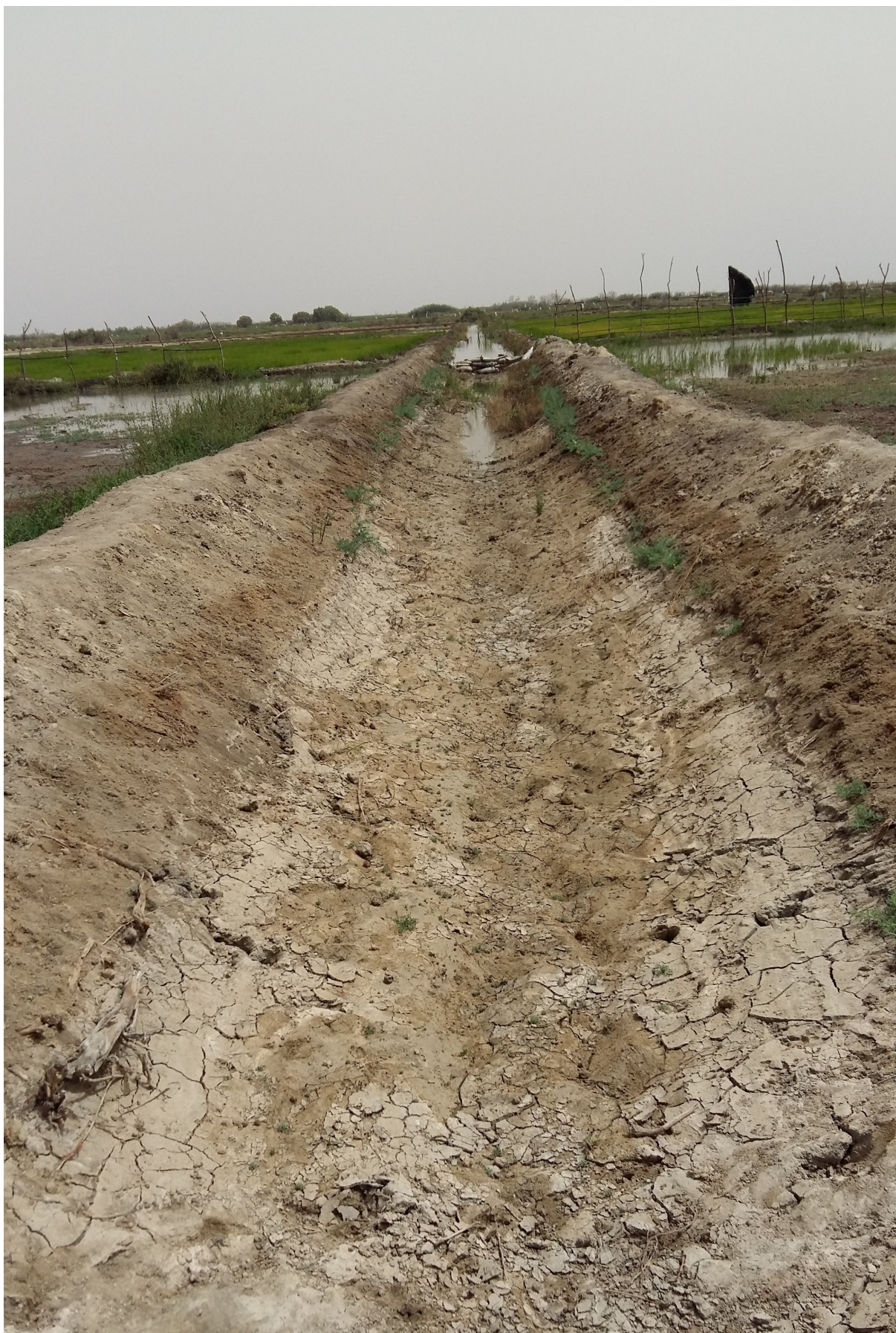
ANNEXE 8 – "Canal de drainage" asséché
