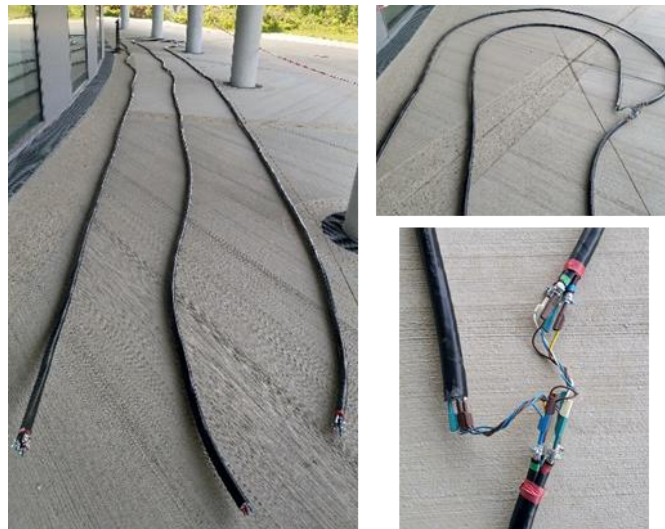
Figure 4-7 : Câbles souterrains connectés en parallèle posés sur sol
