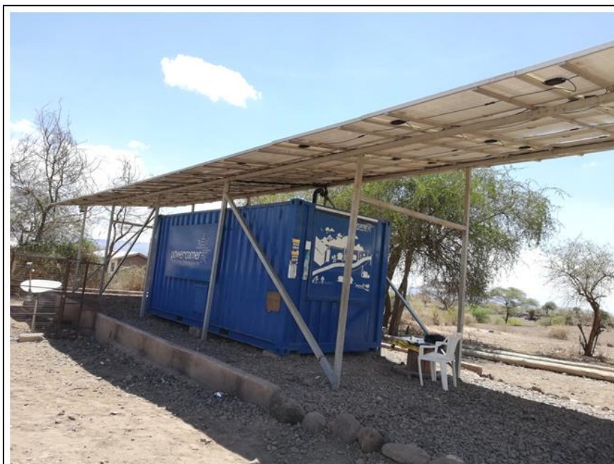
Figure 28 : Une mini-centrale conteneurisée en Tanzanie
